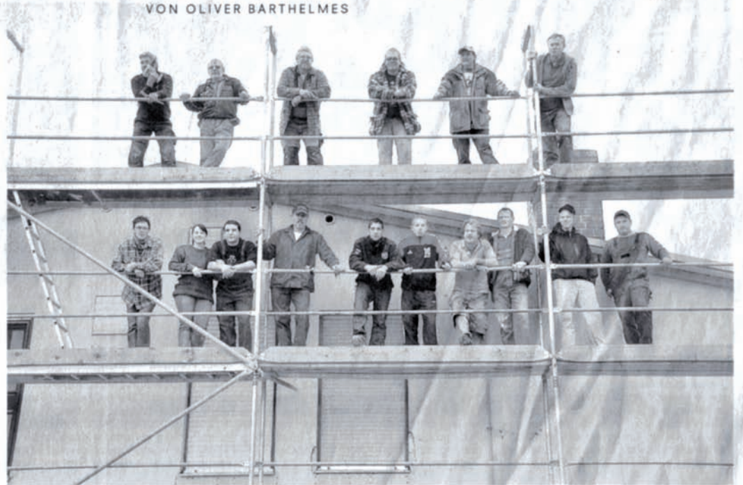
40 Jahre hat ihr Domizil an der Frankenstraße auf dem Buckel. Das Dach haben die Mitglieder der fünf Vereine bereits in Eigenleistung abgedichtet, die Stadt hat angekündigt, ein zinsloses Darlehen zu gewähren. Foto: Barthelmes
